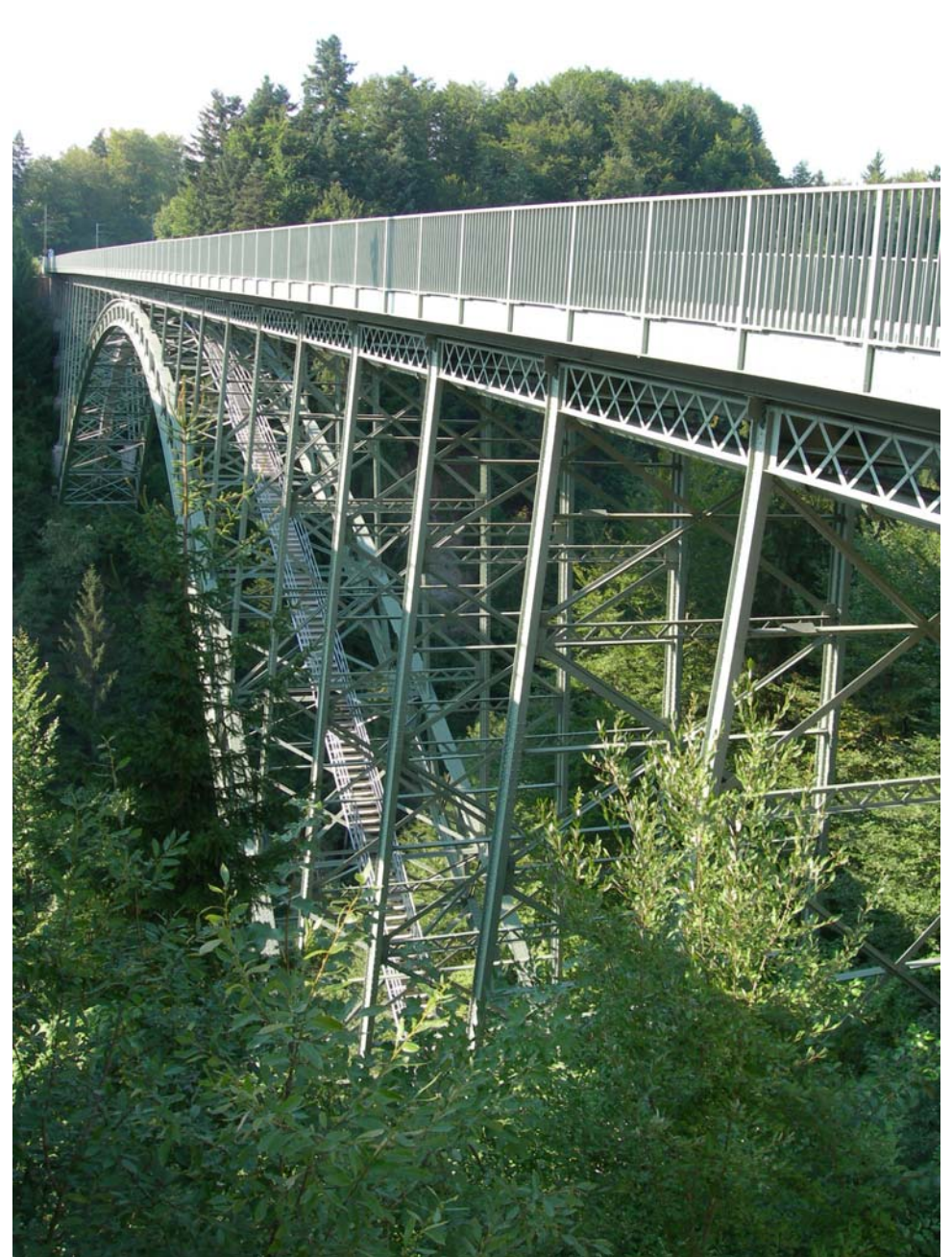
Schwarzwasserbrücke (Strassenbrücke), 1882 Beat Gubser und Firma Ott & Cie Bern Verbreiterung und Instandsetzung 2004
