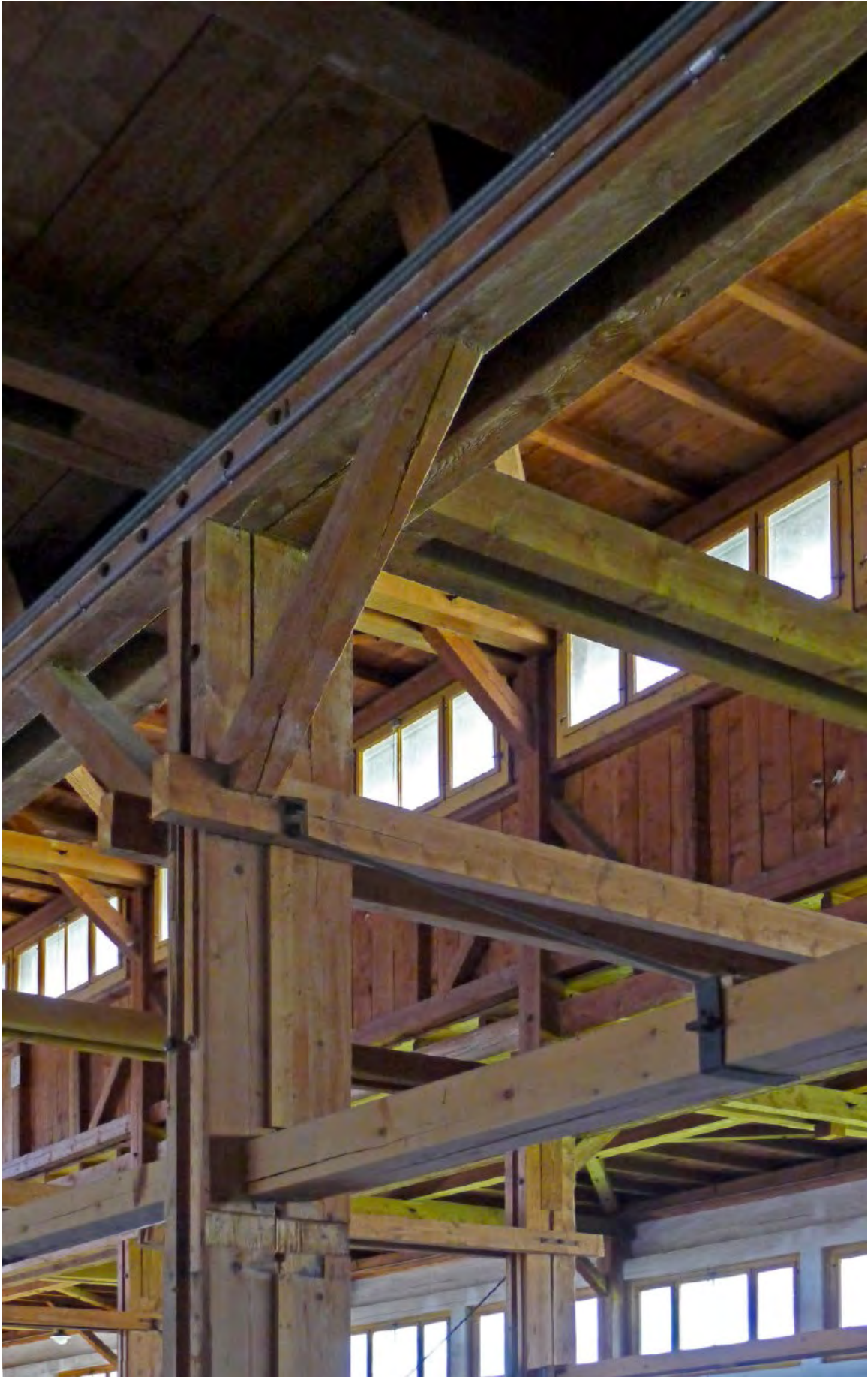
Abb. 45: Holzbauknoten in den Flachlagerhallen von Jakob Wyrsch.
