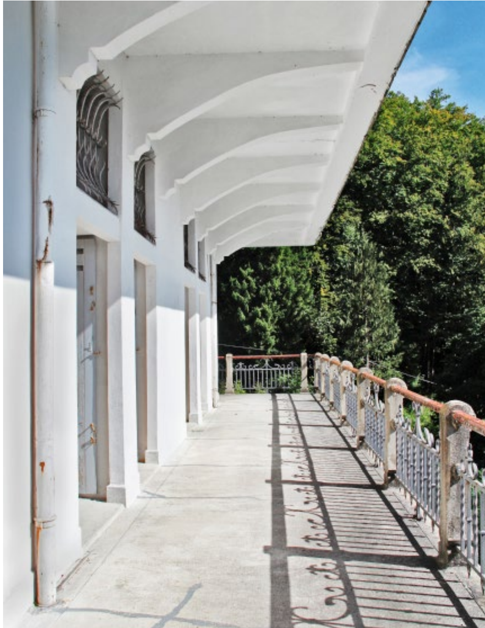
Das Tragwerk des Herrenhauses Hauteroche in Le Pont ist zugleich das architektonische Erscheinungsbild des bautechnisch hochwertigen Bauwerks.
