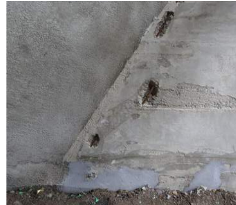
Nachdem die epoxidhaltige Haut abgetragen war, stellte man Schadensbilder infolge Bewehrungskorrosion fest (oben). Sobald die Gewölbeoberfläche mit einem Haftvermittler vorbereitet war (Mitte), trug man die Abdichtungschicht auf PUR-Basis auf (unten).
