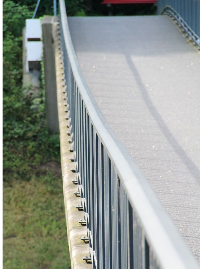
Die Fussgängerbrücke ist seit 50 Jahren in Betrieb und im Original vorhanden. Fahrbahn und Staketengeländer wurden 2003 erneuert und die Widerlager mit kontrollierbaren Ankern verstärkt.
