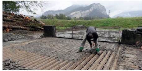
Instandsetzung: Die Stahlträger und Zoreisen reinigte und legte man von Hand frei.
