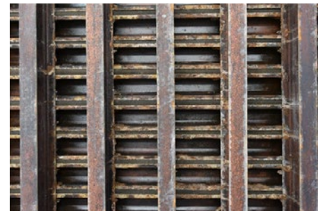
Fahrbahnuntersicht: Die Tragkonstruktion wurde gründlich trocken abgebürstet, aber nicht weiter gereinigt. Der Oberflächenrost wurde bewusst als Schutzschicht belassen. Weissliche Verfärbungen stammen von ausgewaschenem Kalkstaub des ursprünglichen Strassenkoffers.
